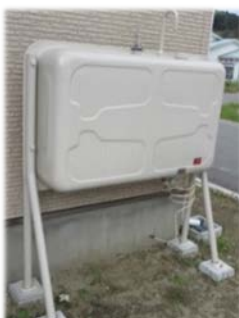
ホームタンク
