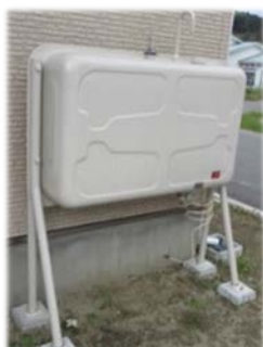
ホームタンク
