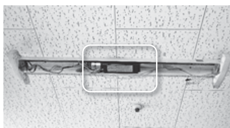
業務用照明器具安定器
