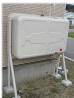
ホームタンク
