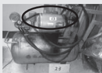
コンプレッサに取り付けられた低圧コンデンサー
