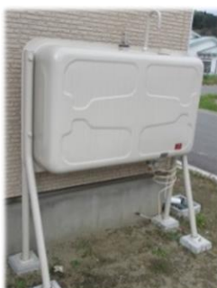
ホームタンク
